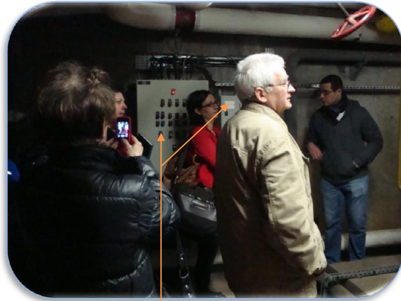
L'installation est reliée à un automate, sorte de « tour de contrôle » de la chaufferie :
