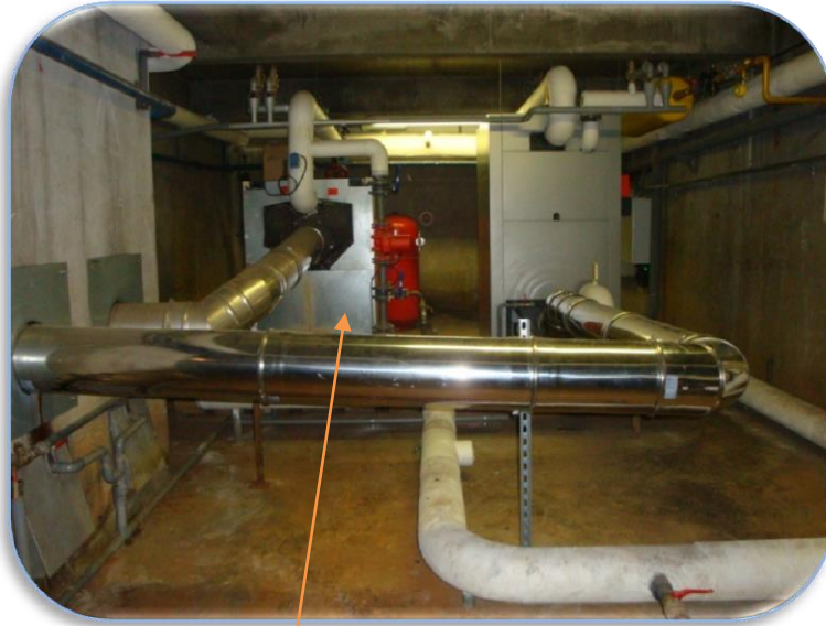
L'installation vue de derrière
